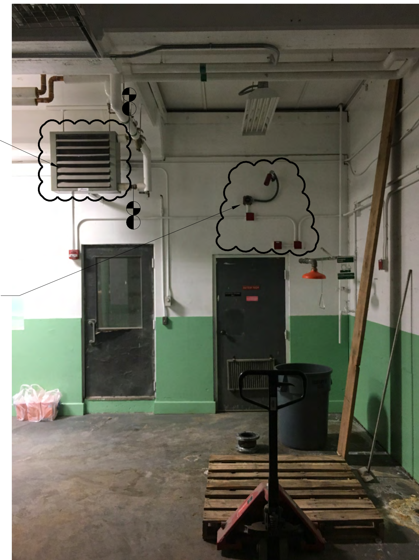
3 ORIGINAL UNIT HEATER (DEMO) N.T.S.
